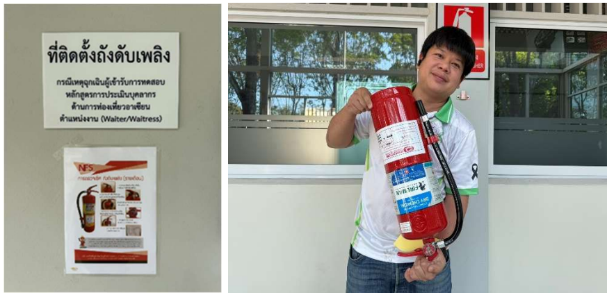
การตรวจสอบถังดับเพลิง
