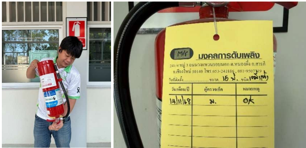
รายงานตรวจสอบถังดับเพลิง ชั้น 1 อาคารสุวพรรณวจากกสิกิจ ประจำปี 2568
