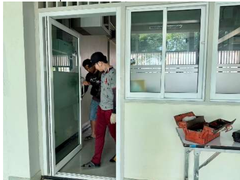
ตรวจเช็คสภาพประตูให้ปิดสนิท ป้องกันแอร์รั่วไหล (วันที่ 25 พฤษภาคม 2567)
